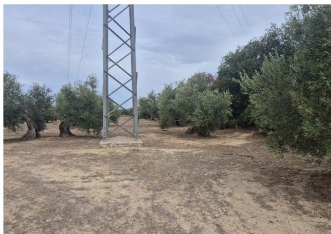
INTERIOR DE LA FINCA CON LA LÍNEA DE MEDIA TENSIÓN
